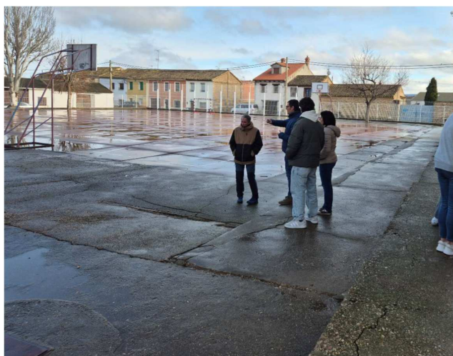
Zona de actuación del pavimento deteriorado en zona de paso entre patios desde el de Primaria
